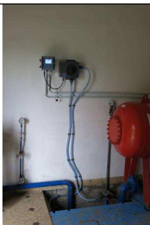
Appareillage de mesure de la turbidité par piquage de l'eau sur le refoulement (avril 2014)
