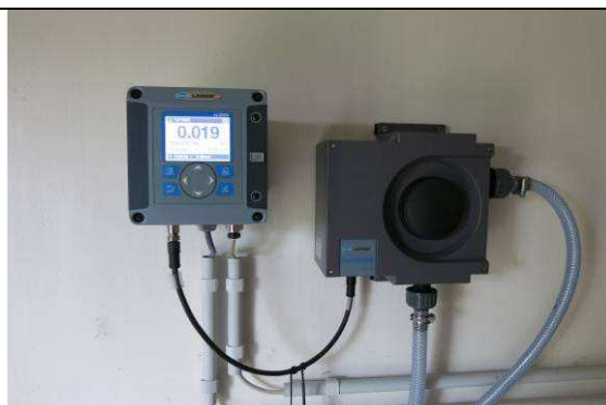
Boîtier pour la mesure de la turbidité et afficheur dans la station de pompage (avril 2014)
